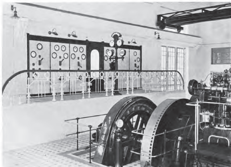
Видъ распределительной доски на вышеозначенной станціи.
